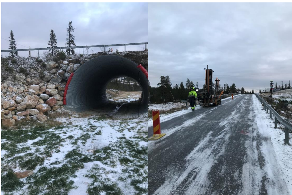
Figur 6.3. En del av bron sett från skidbacken till vänster och vägytan på bron till höger
